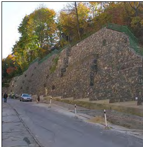
Obrázok 25. Oporný systém na Hornom Šianci. Na zaistenie svahov Breziny bola použitá technológia drótokamenných matracov. Autor: P. Chrastina (X. 2005)
